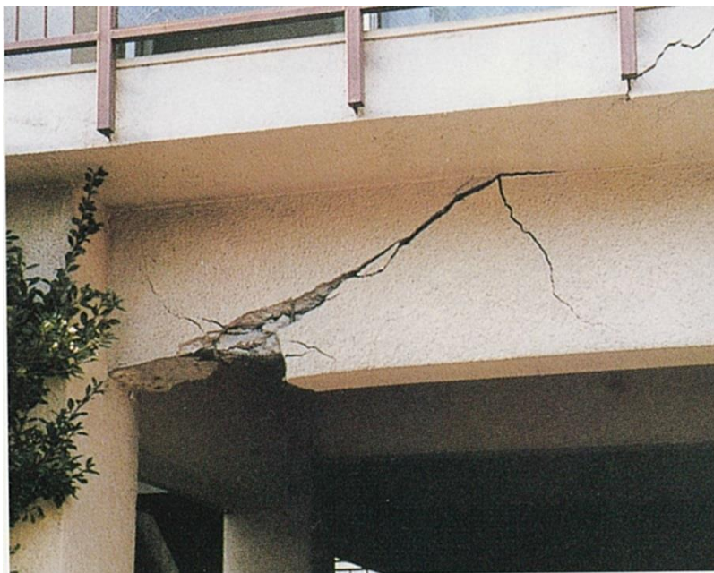
梁のせん断破壊
