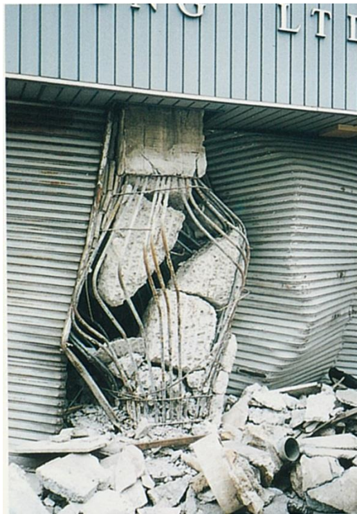
柱のせん断破壊
