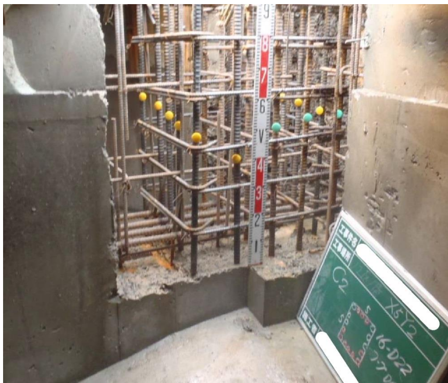
柱配筋の間違いによるハツリ
