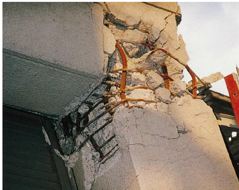
柱梁接合部の被害
