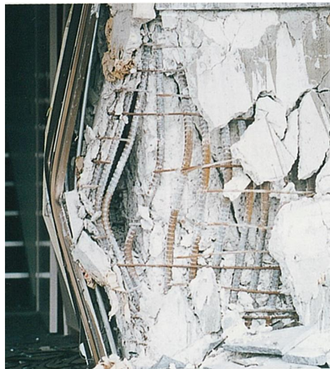
柱のせん断破壊
