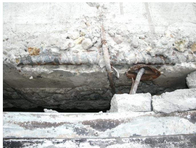
梁下端のかぶり不足
