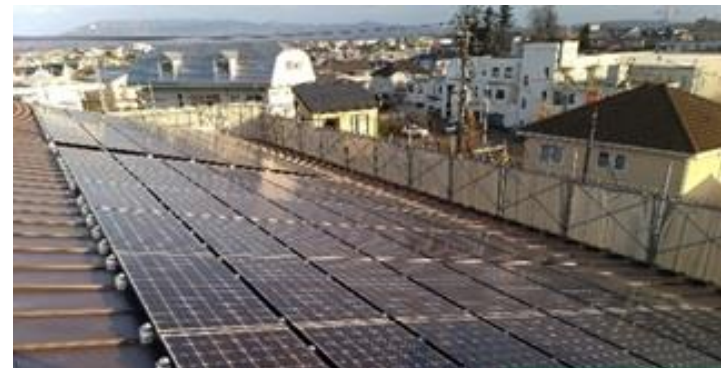
太陽光パネル (屋根)
