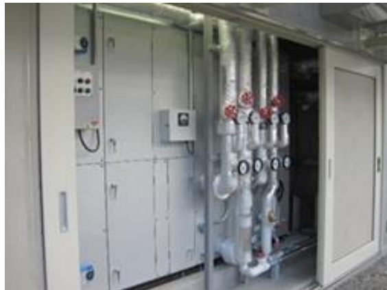
地中熱利用・ 潜熱顕熱分離空調 (1階機械室)
